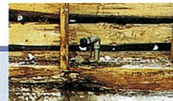
水漏れが原因で腐った家の土台
