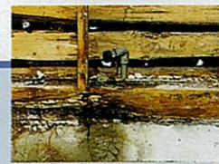
水漏れが原因で腐った家の土台
