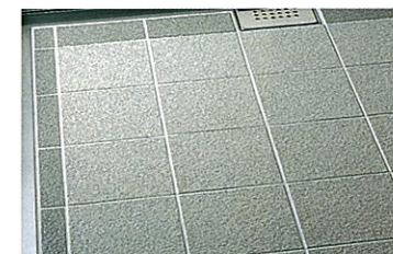
標準洗い場1.5坪サイズ・フラット洗い場: グレー(磁器タイル/200mm角)
