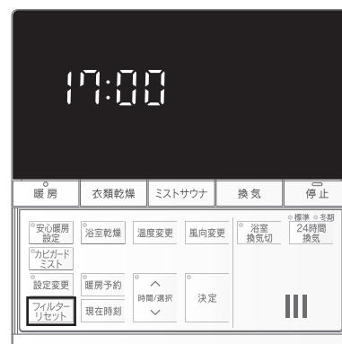
(脱衣室リモコン)
