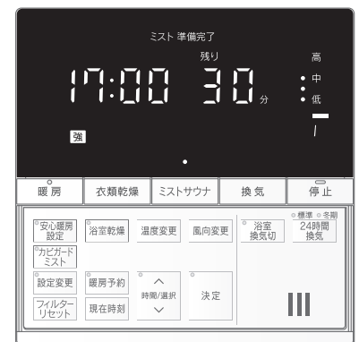
(脱衣室リモコン)
