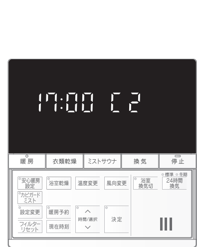
(脱衣室リモコン)
